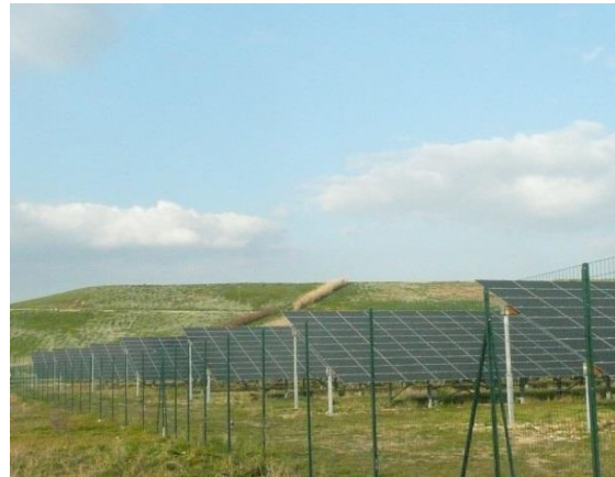
Photo 25 : Centrale solaire au Mas neuf de Baussenq - Source : SMC (2013)
